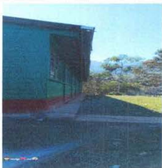
Foto 3: se observa el deterioro de las canaletas
