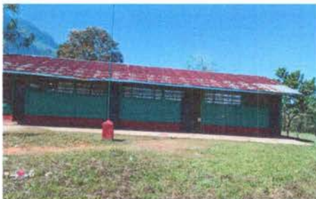
Foto1: Observacion: Se Observa el deterioro del techo
